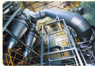
2003(平成15)年2月 本格操業を開始した厚別RDFプラント
