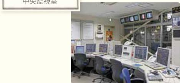
メインプラント 中央監視室
