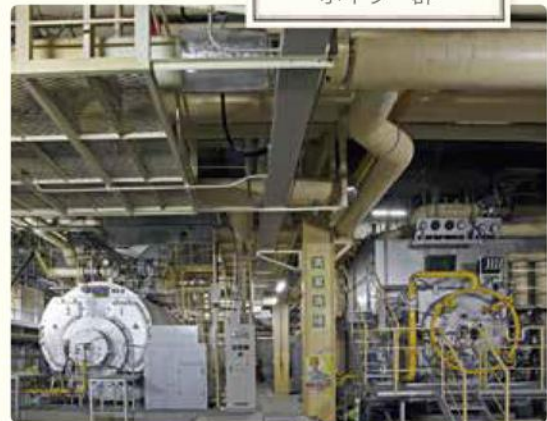
メインプラント ボイラー群
